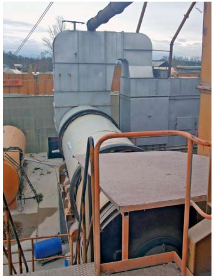
Trocknungsanlage für Gesteinskörnung in einer Asphaltmischanlage
