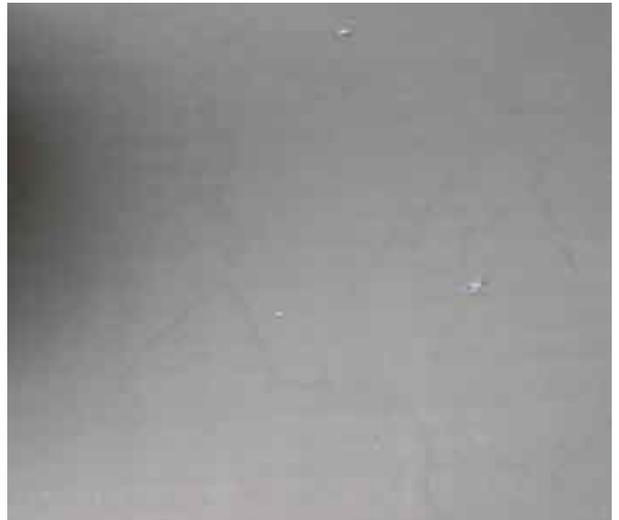
Abb. 6 Fließestrichoberfläche ohne optimierte Sieblinie
